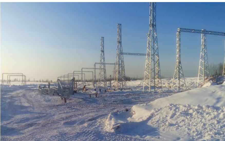
ПС 500 кВ Усть-Кут
