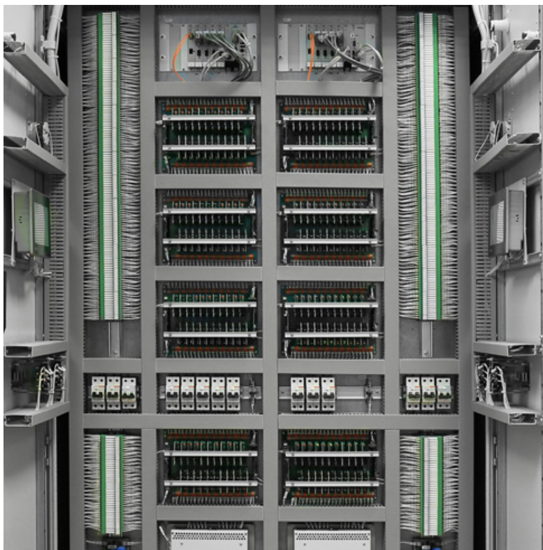
Локальная автоматика предотвращения нарушений устойчивости (ЛАПНУ)
