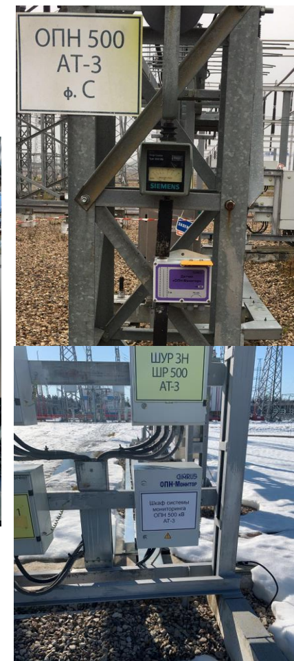
Шкаф и датчик мониторинга ОПН
