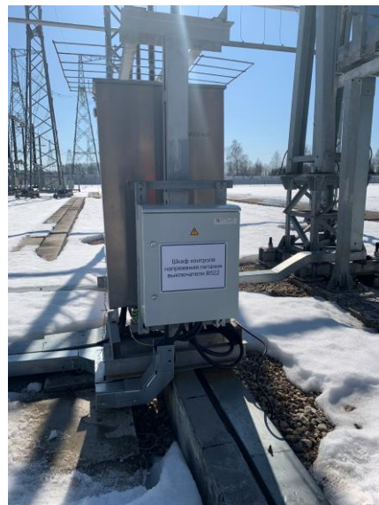
Шкаф контроля питания выключателей
