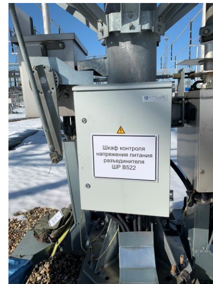
Шкаф контроля питания разъединителей
