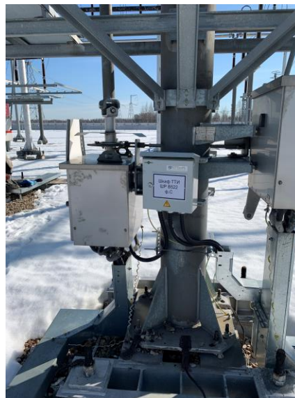
Шкаф ТТ контроля питания выключателя
